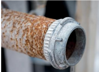
Deterioro debido a una atmósfera química corrosiva
